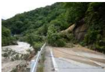
【国道158号(松本市安曇中ノ湯) 法面崩壊】
