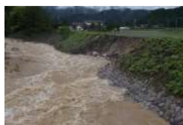
【一級河川 穂高川(安曇野市 鼠穴橋下) 護岸決壊】
