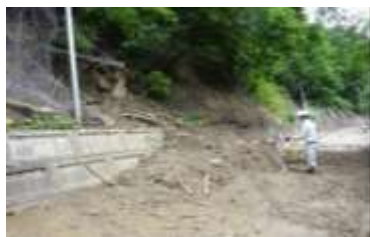
【生坂村下生野地区 法面崩壊】
