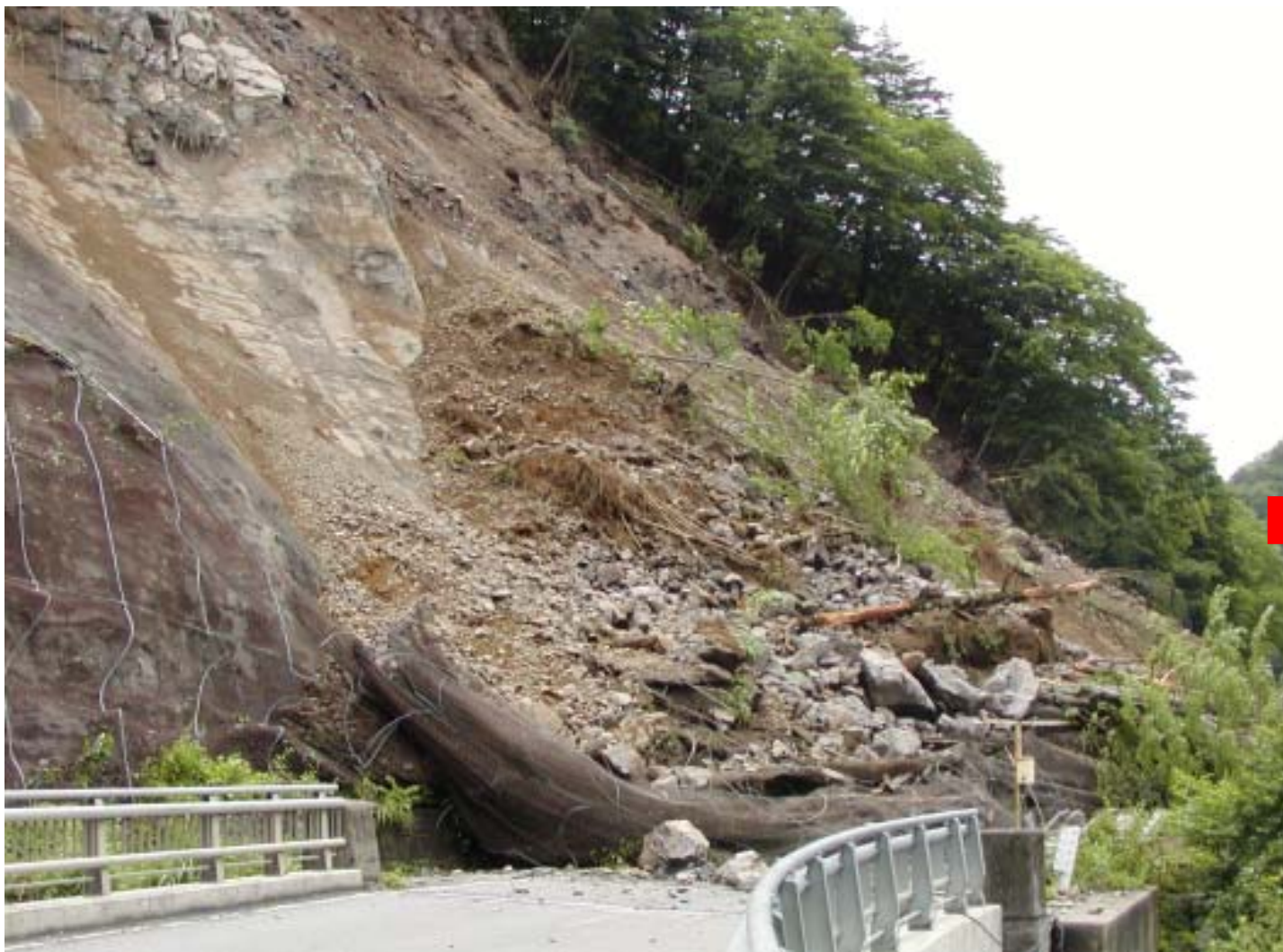
整備前（被災状況）
