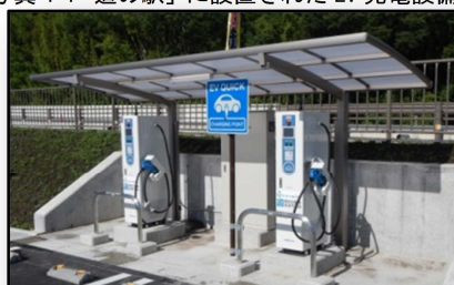
写真1:「道の駅」に設置されたEV充電設備例
