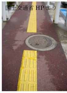
視覚障害者誘導用 ブロックの不適切事例
