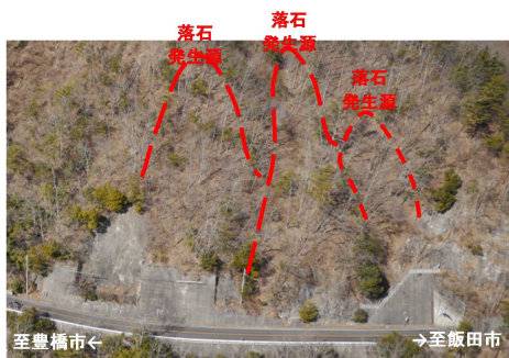
写真 1: 道路区域外から落石等危険の恐れがある道路法面の調査イメージ (国道 151 号阿南町落合)
