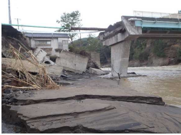
(主)丸子東部インター 東御市 田中橋 (令和元年東日本台風)
