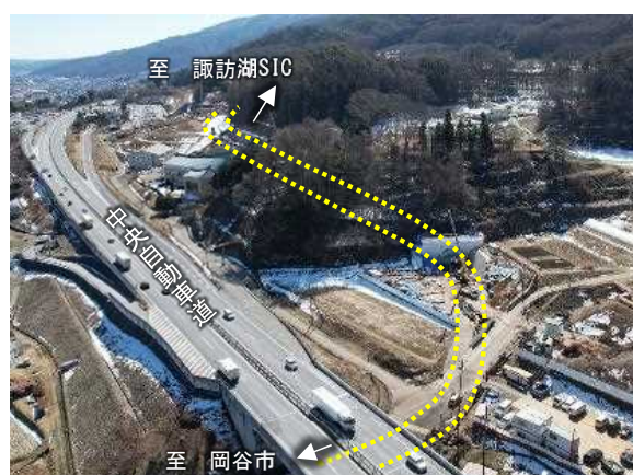
(主)諏訪辰野線 岡谷市～諏訪市 小坂～有賀 (平山トンネル施工状況)
