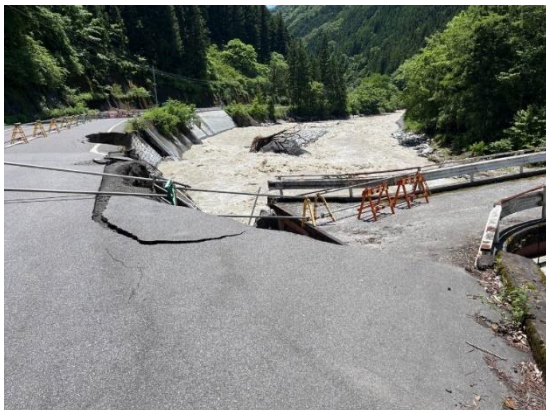
飯田市上村国道152号線の陥没
