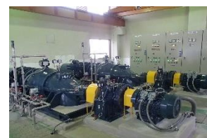
【整備した排水ポンプ設備】
