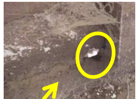
ホコリがなく動物の通過が考えられる隙間
