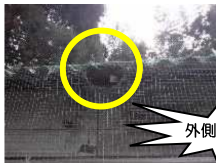
家きん舎側面の防鳥ネットの破損
