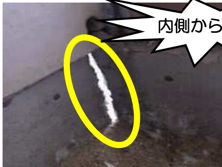
家きん舎の基礎部分にヒビ割れ
