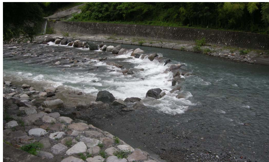
帯工上流側の土砂流出後の様子
