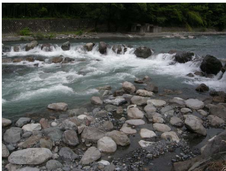
変状が確認された帯工の様子
