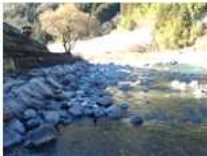
施設の状況（平成28年出水後）
