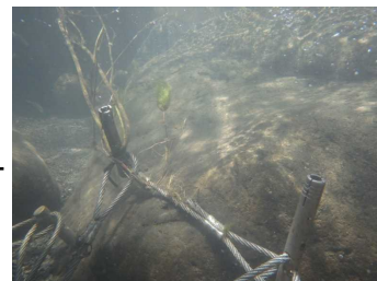
抜けたアンカーの様子（水中）
