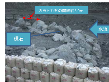
巨石落差工は、上流側にアーチを形成させる。
