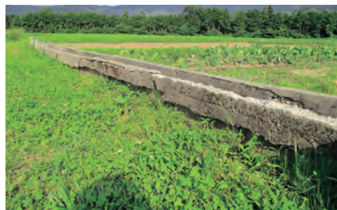
老朽化した水路（伊那市 東原地区）
