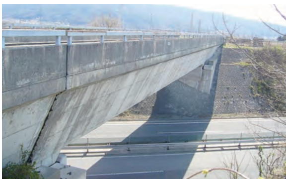
耐震対策が必要な高速道路を跨ぐ水路橋（箕輪町 西天竜地区）
