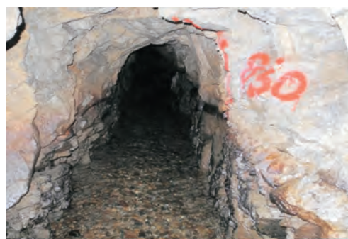
崩落の危険のある水路トンネル （飯島町 新井地区）
