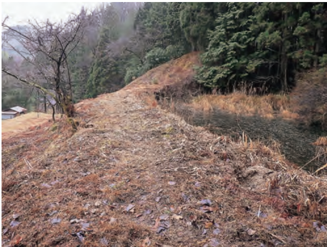
堤体の浸食が進む農業用ため池（南木曾町）
