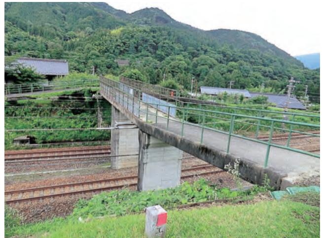
老朽化が進行する跨線農道橋（南木曾町）
