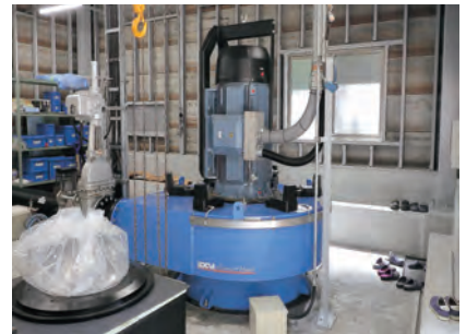
吉野小水力発電所 (上松町)
