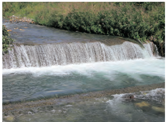
堰堤の欠損により取水困難となった頭首工（木祖村）
