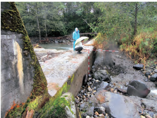
洗堀が進み取水困難となった頭首工（木曾町）
