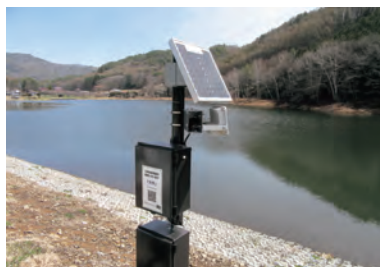
ため池監視システム (木祖村大平ため池)
