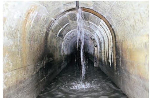
補修が必要な水路トンネル（竜東一貫水路）
