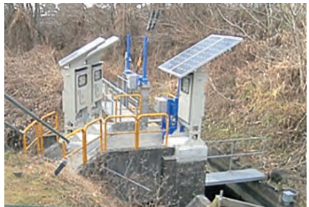
遠隔操作が可能な水門自動化装置（分杭水門）
