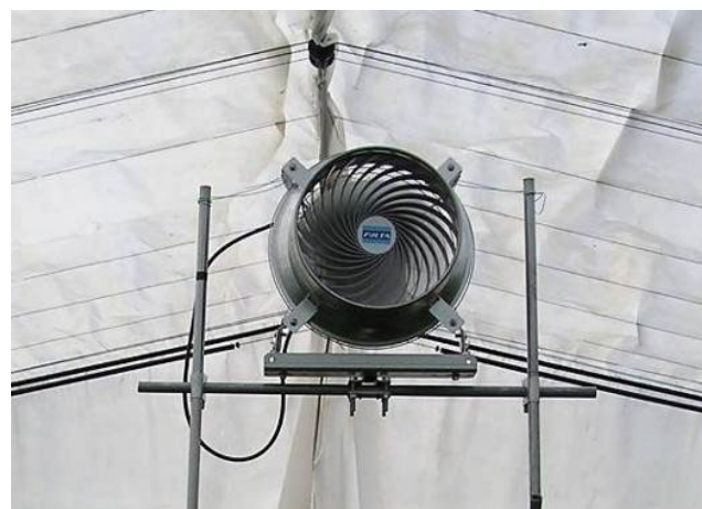
【〇】循環扇の設置によるハウスの省エネ対策
