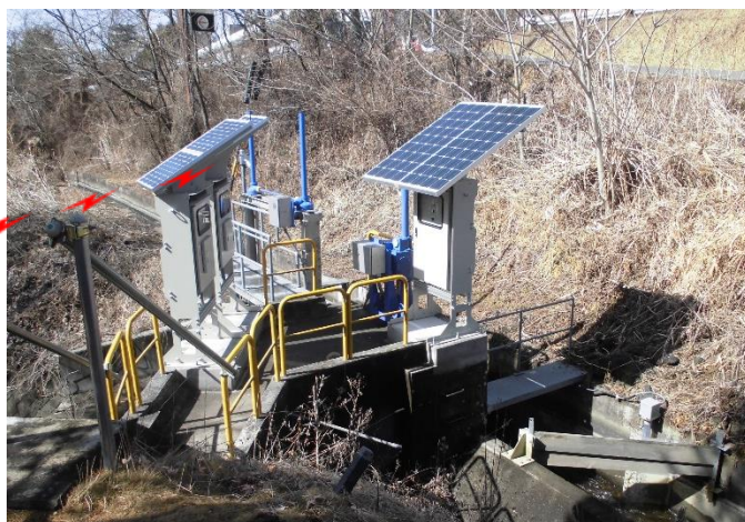
【スマートフォンによる排水門の遠方制御】
