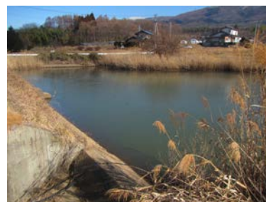
【耐震性能が無く危険なため池】
