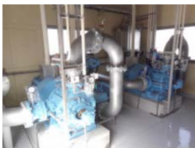
【更新した排水ポンプ】
