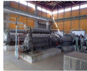
②【老朽化した排水ポンプ（長野市）】
