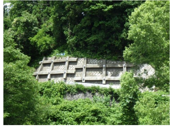
【地すべりを防止するための抑止工事】 地すべり対策事業 飯山南部地区（飯山市）
