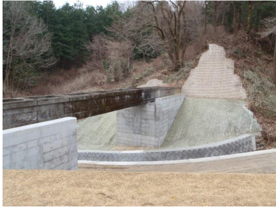
【耐震補強工事を実施した水路橋】 県営農村地域防災減災事業 竜西2期地区（飯田市）
