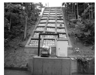
【小水力発電施設】
