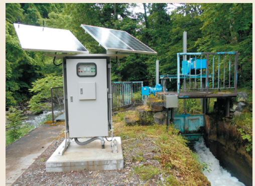
【太陽光を利用した遠隔化水門（倉井用水：飯綱町）】
