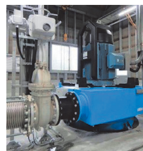
【上松町吉野発電所】
