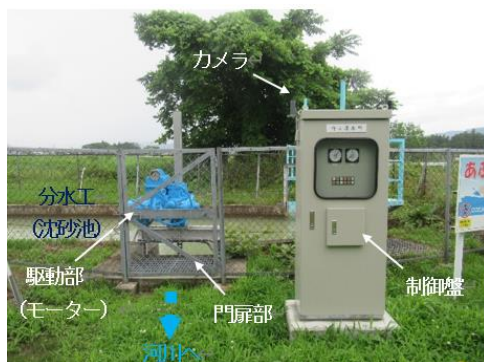
【遠隔制御化した分水工排水門】
