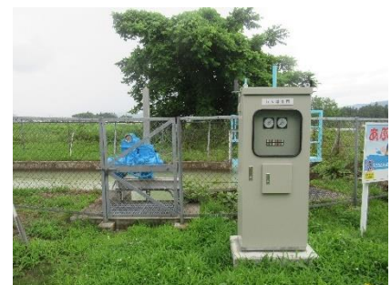
【自動化・遠隔化した水門】
