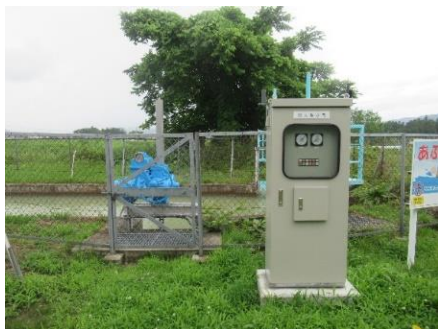
【操作を遠隔化した水門】
