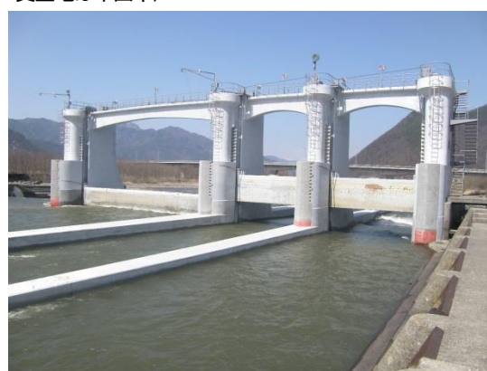
【表面被覆により劣化の進行を抑制】
