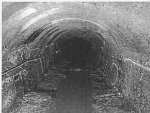
【老朽化が進んでいた水路トンネル】
