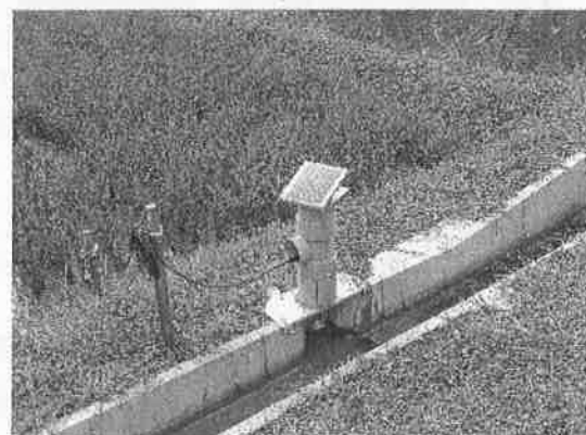
【遠方操作が可能な給水栓（二重地区）】
