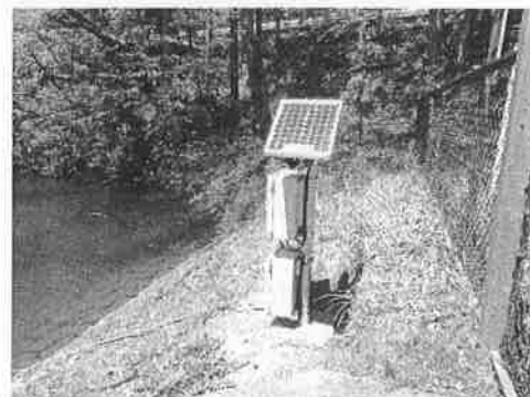
【監視カメラの設置（長野市：名知不池）】
