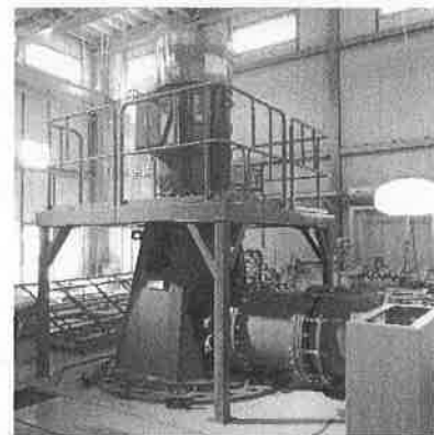
【更新後：ポンプ（立軸形式）】
