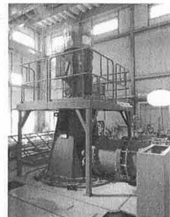
【更新した排水機場のポンプ （長野市：牛島排水機場）】
