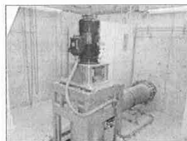
【農業用水を活用した小水力発電施設】
