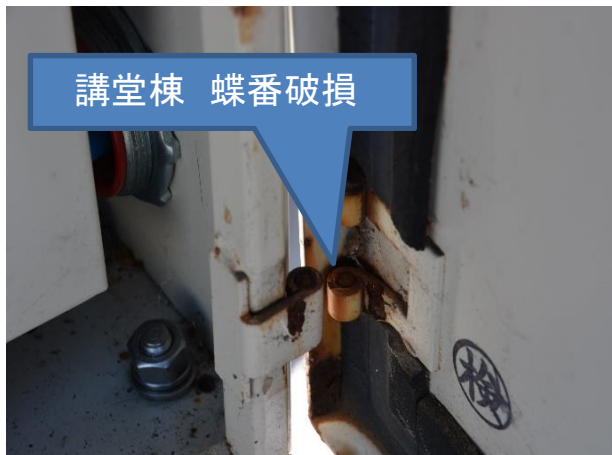
③講堂棟分電盤電源ボックスの蝶番破損状況
