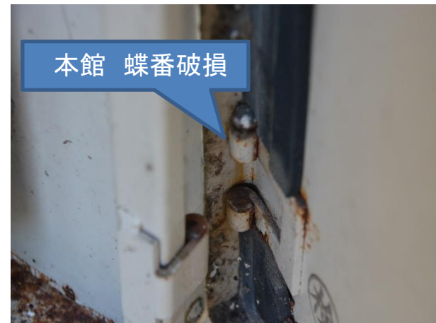
②本館分電盤電源ボックスの蝶番破損状況
