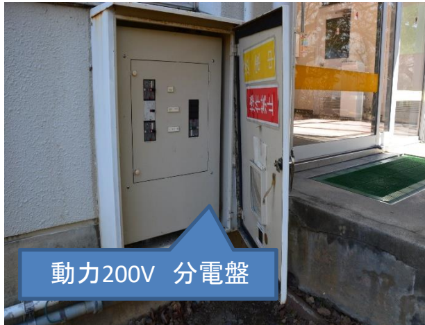
①本館分電盤
