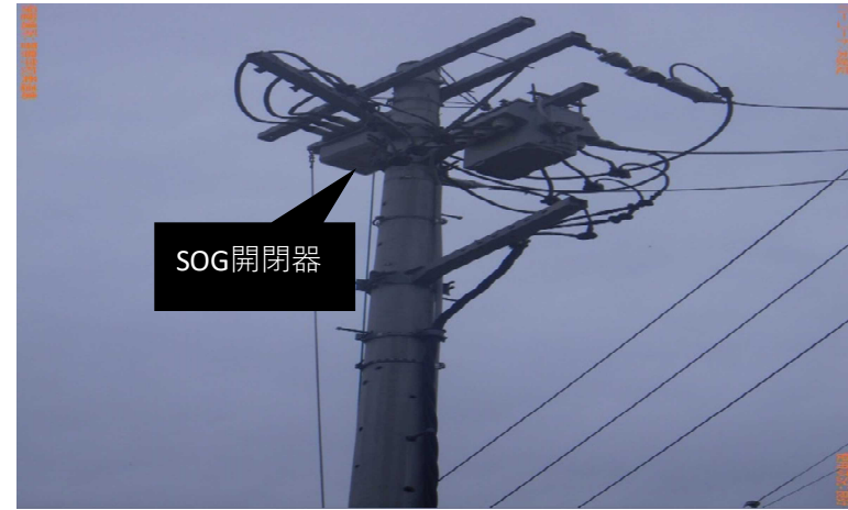
②警察学校高圧受電設備から外部（近隣住宅）への波及事故を防止する装置
