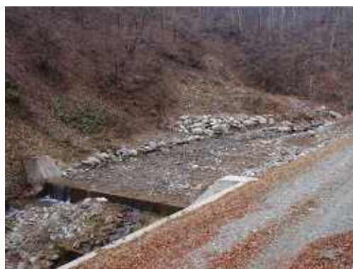
写真-2 コンクリート製帯工の上流側に施工された木工沈床工、空気に触れないため、腐朽速度は遅い
