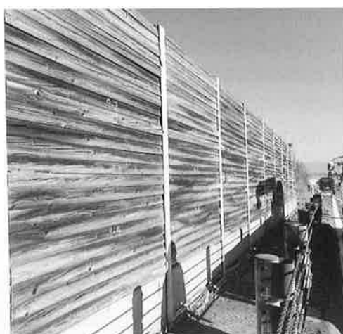
写真1 約30年経過のカラマツ製遮音壁
