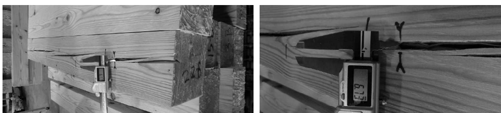
写真-1 最大割れ幅測定状況
