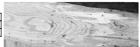
写真-1 乾燥後の穿入孔
