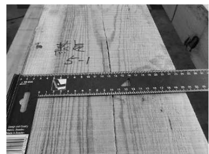
写真-1 割れの状況
