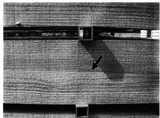
写真-3 乾燥中に閉塞した材面割れ
