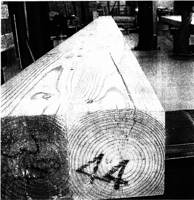
写真-5 接着重ね梁の削り残し部分 (右上部分)
