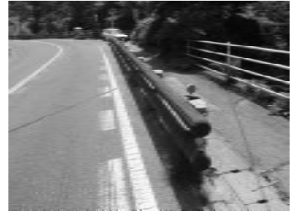
写真3 3号型の設置状況
