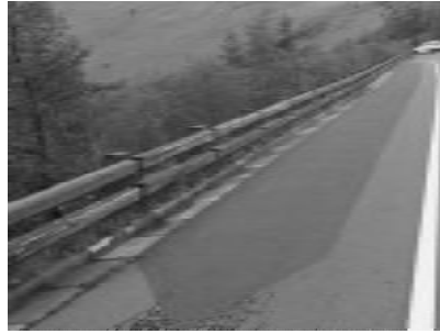
写真2 2号型の設置状況
