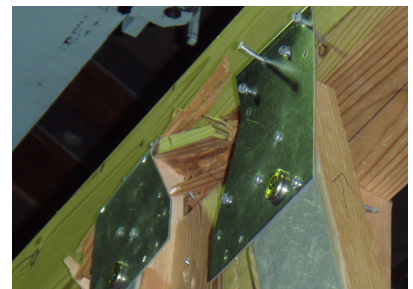
写真 3-3 g3 試験体梁破壊部
