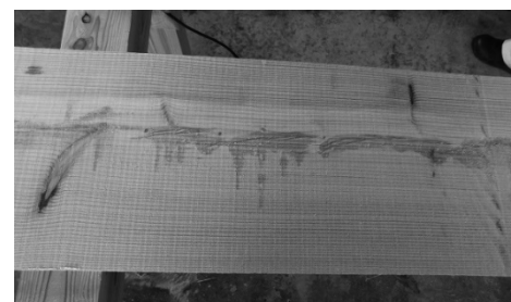
写真4-12 髓割れ部分からのヤニ滲出(カラマツ)
