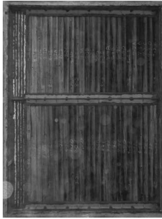
④ カラマツ製遮音壁 (スキマ一部有)
