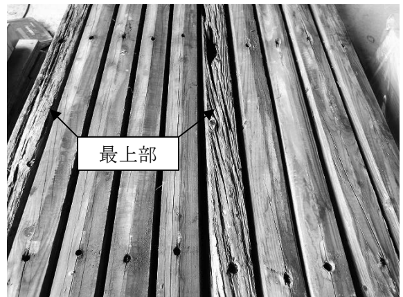
写真-5 劣化状況
