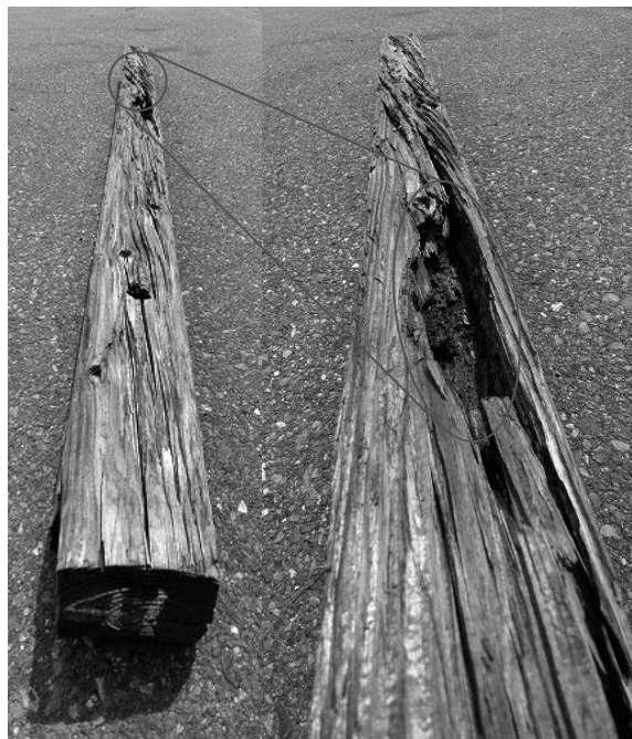
写真-6 遮音壁最上段の部材の劣化状況
