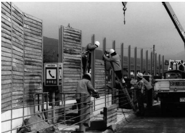
写真-1 1985年度末に設置されたカラマツ製遮音壁
