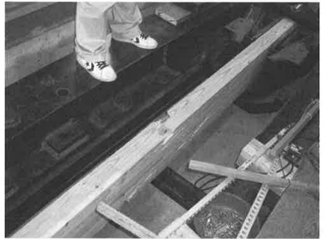
写真 3-3 集成材の引張り破壊
