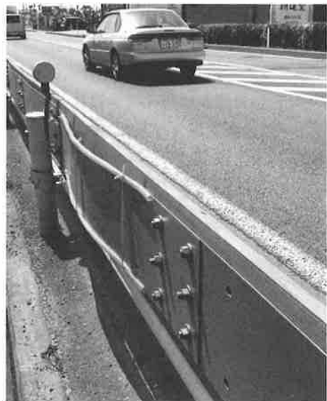
写真-2 鋼板の膨れ(応急処置として上下にビニールホースが付けてある)
