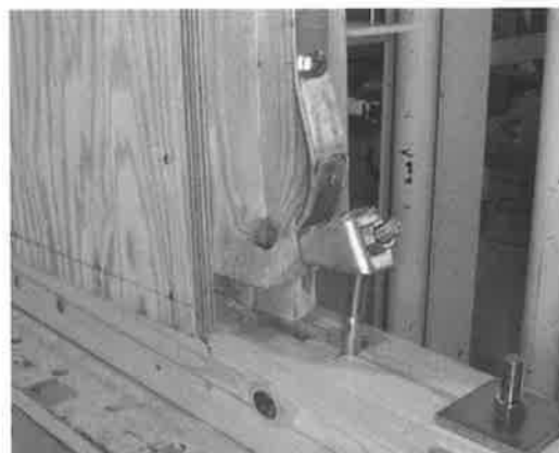
写真 4-1 柱脚固定金物破断 (24k-3 試験体)
