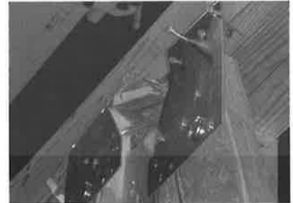
写真 3-3 gf3 試験体梁破壊部
