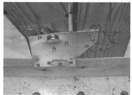
写真 2-2 釘の変形・引き抜け (No. 6 試験体)
