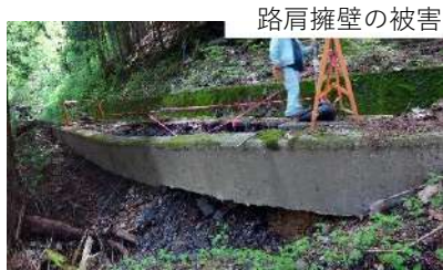
路肩擁壁の被害
