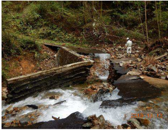
路体流出: ほどがい線(上田市)
