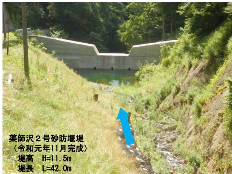
土石流発生前 (R3年.10月撮影)
