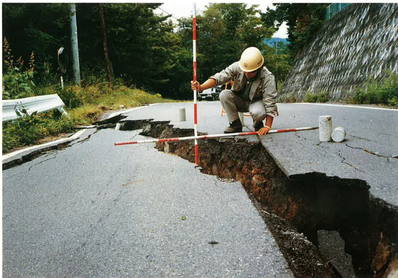
(路面に生じたキレツと沈下)
