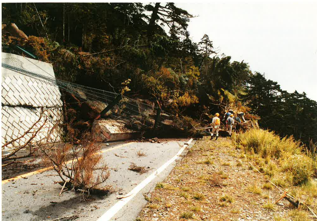
(山脚崩壊と法留ブロックの転倒)
