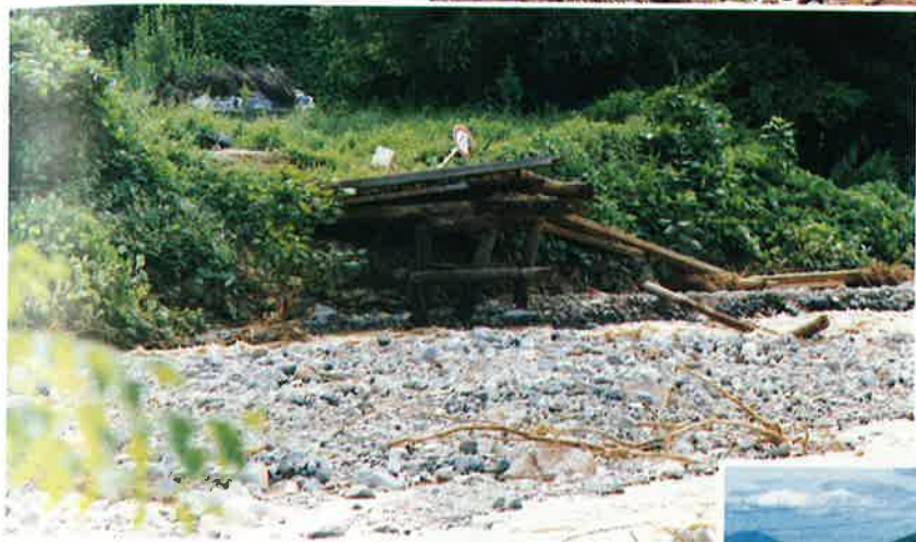
全壊した午橋の残がい(上八町)
