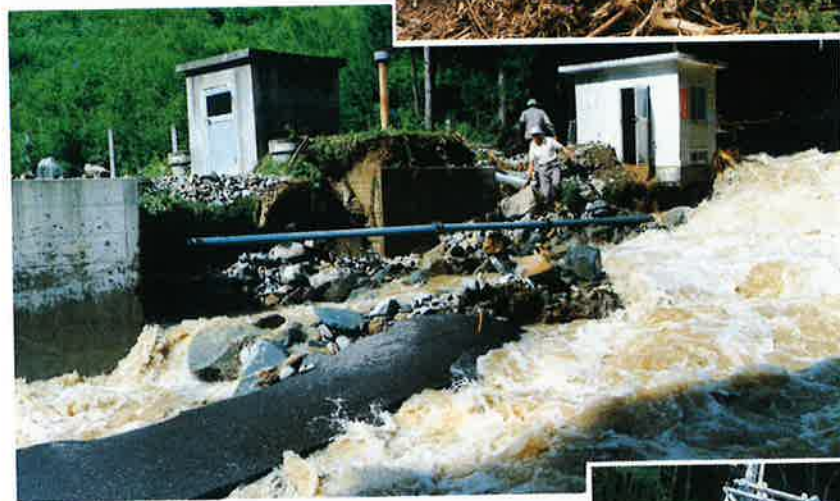
使用不能となった豊丘浄水場 (豊丘上町上原地区)
