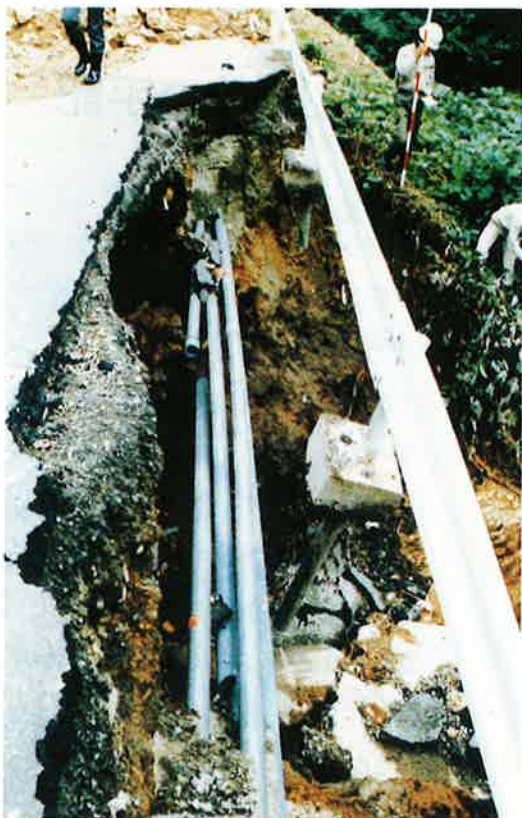
地中ケーブル切断 (仁礼町)
