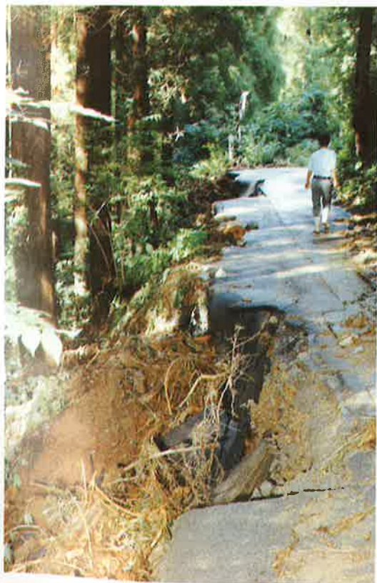
路肩が崩落した県道五味池高原線(豊丘上町上原地区)
