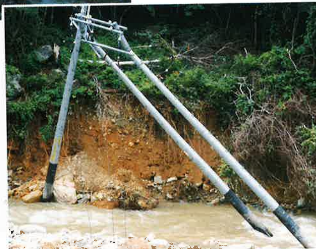
電柱倒伏 (仁礼町)
