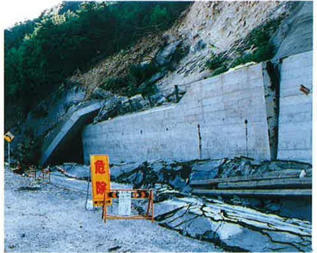
崩壊した土留擁壁と盛り上がった道路(7/26)
