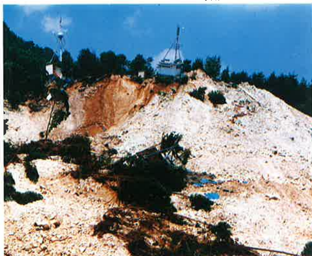
倒壊寸前(後方)、倒壊(手前)のテレビ中継所
