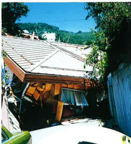
道路上に押し出された家屋
