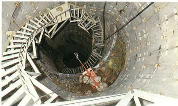
◀二次崩落で変状(セン断)が生じた5号集水井
