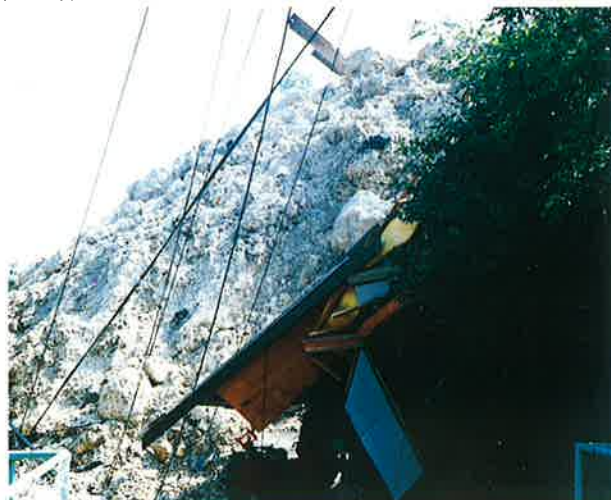
完全に押しつぶされた家屋（団地北側）と有料道路のH鋼杭
