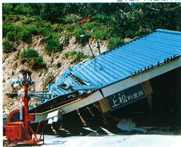
押しつぶされた有料道路料金所(松寿荘横)
