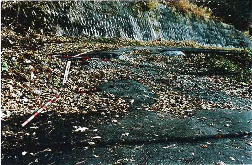
H7.11 撮影 Aブロック東頭部。村道の変状。
