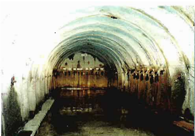
排水トンネル終点集水ボーリング室 (No.5)
