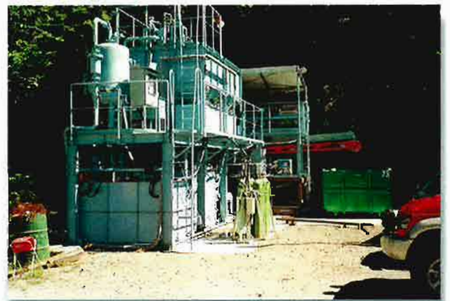
濁水処理設備
