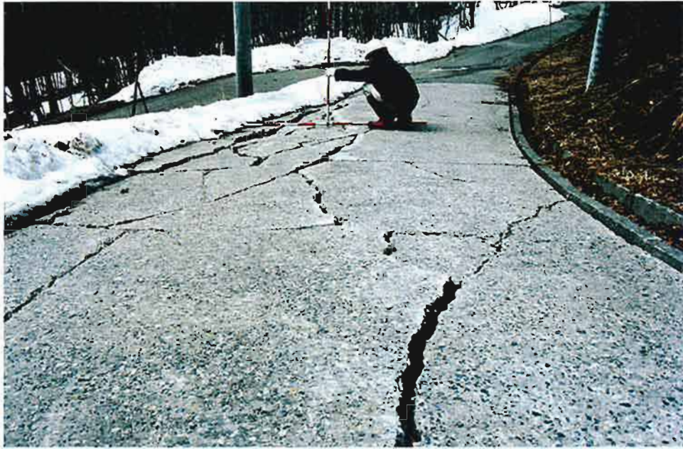
H10.3 末撮影 Aブロック頭部。村道の変状。
