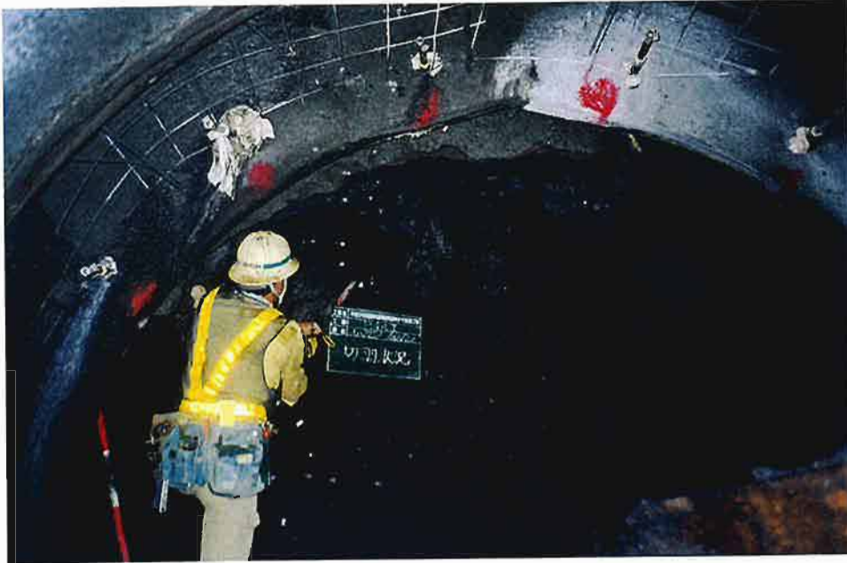
写真-3 切羽No.275.3 天端直下から左側上部（黒板上のところ）では、湧水により切羽から崩落土砂が供給される。灰白色砂質泥岩～黒色泥岩（礫混り土砂状）部の崩壊が著しい状況となっている。
