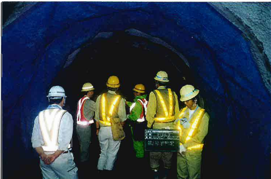
写真-4 切羽No.275.3 前面における排水トンネル天端-側壁部分の漏水処置の状況。切羽も自立できず、前面も滴水が著しい状態となる。
