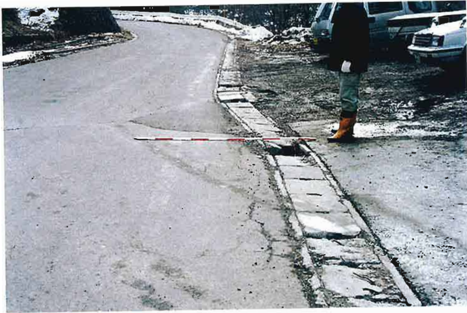
H8.12 撮影 Aブロック東側部。村道のズレ。
