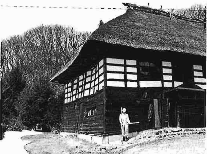
③ 保存家屋の変状と40cmの段差
