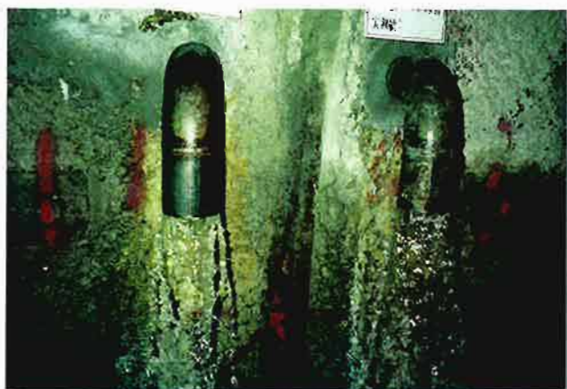
集水ボーリング室出水状況
