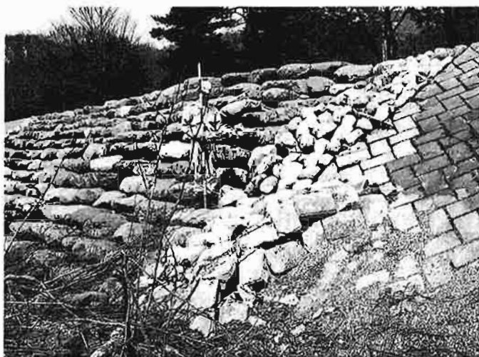
② Aブロック末端東側部の高水位護岸工の変状
