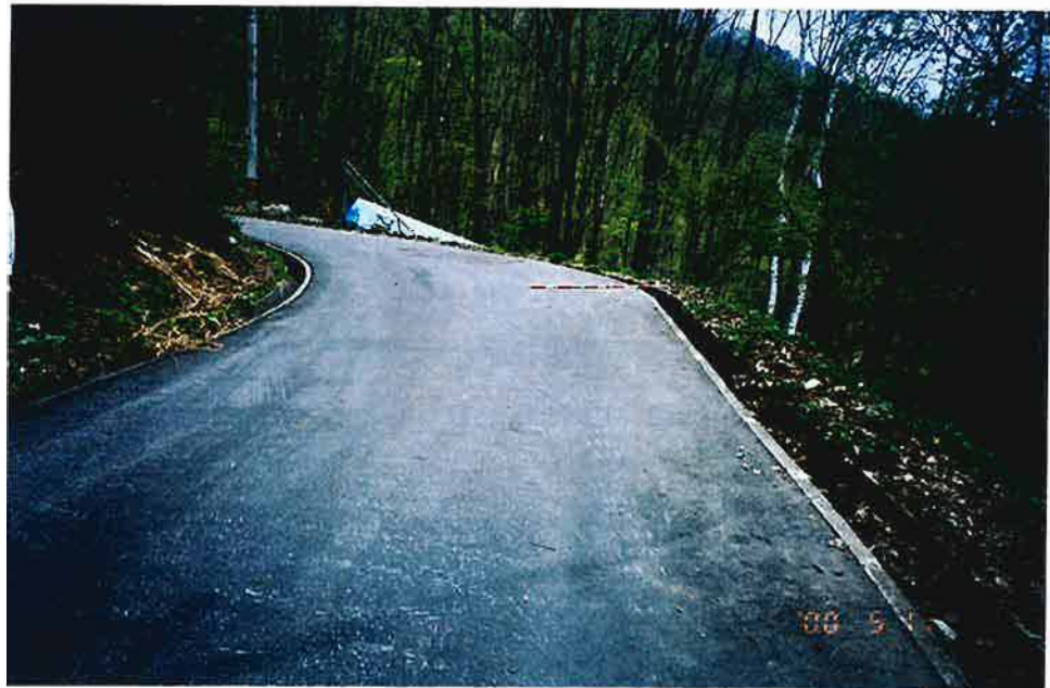
H12.5.11 撮影 Aブロック頭部。村道の変状。H11.4 補修。 路肩にヘアクラック認められる。
