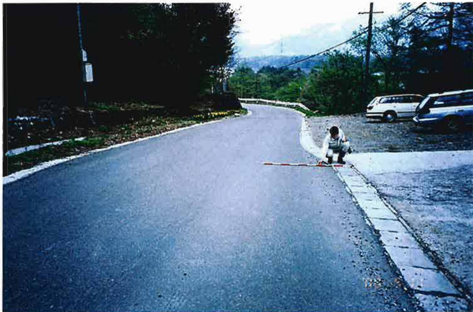
H12.5.11 撮影 Aブロック東側部。村道のズレ。 H11.4に補修。拡大傾向は認められない。
