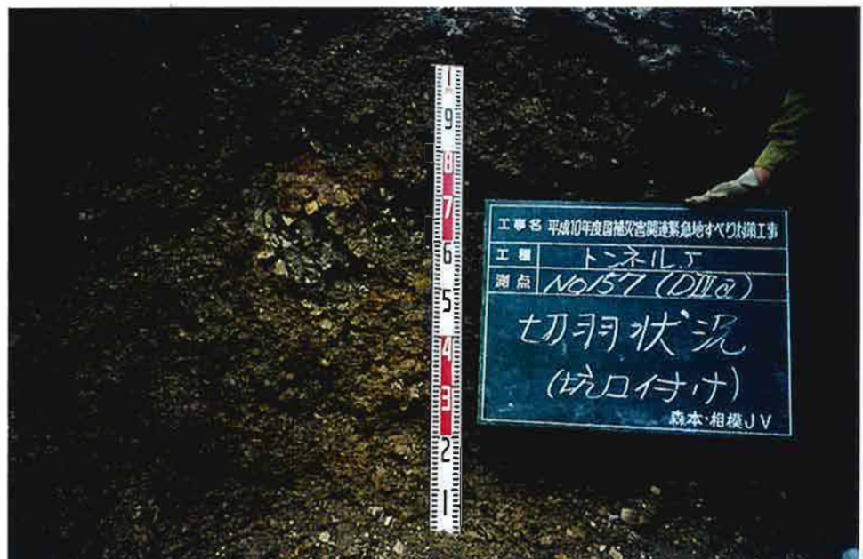
写真-2 切羽No.157の拡大写真。凝灰岩質の岩片が含有される。 全体に土砂状となっている。
