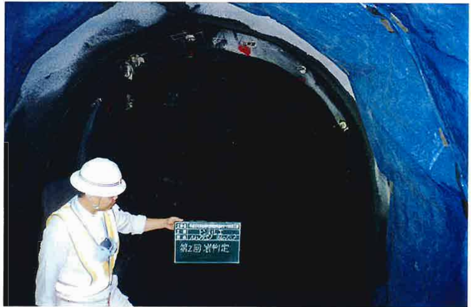
切羽No.275.3 の状況。右上半より右下半へ向けて単斜構造の互層を示す。左上半より灰白色砂質泥岩～黑色泥岩（礫混り土砂状）～黑色泥岩（岩盤状）～粘性土へと変化している。 写真-1
