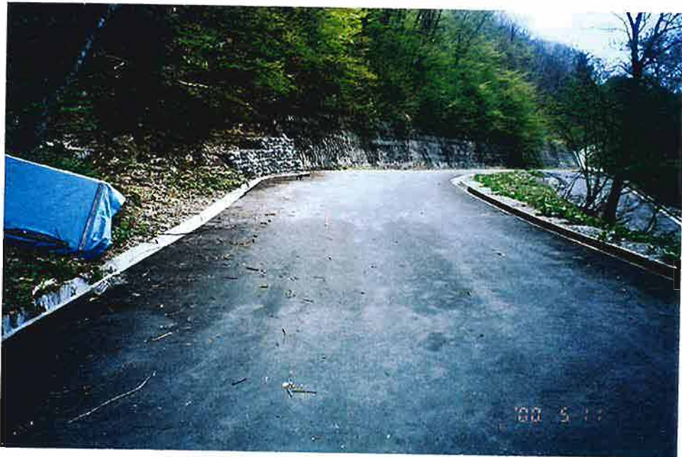
H12.5.11 撮影 Aブロック東頭部。村道の変状。 ヘアクラック認められる。
