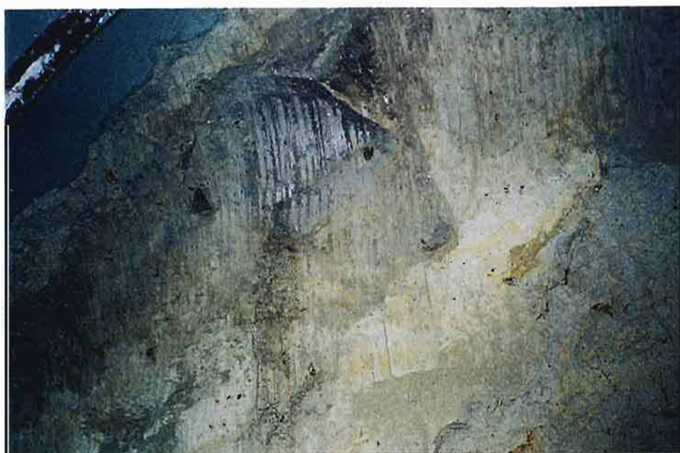
写真-2 切羽状況No.223 右上半の拡大写真。白色を呈する強風化凝灰岩層で、ハンマー打撃により容易に砕くことができる。
