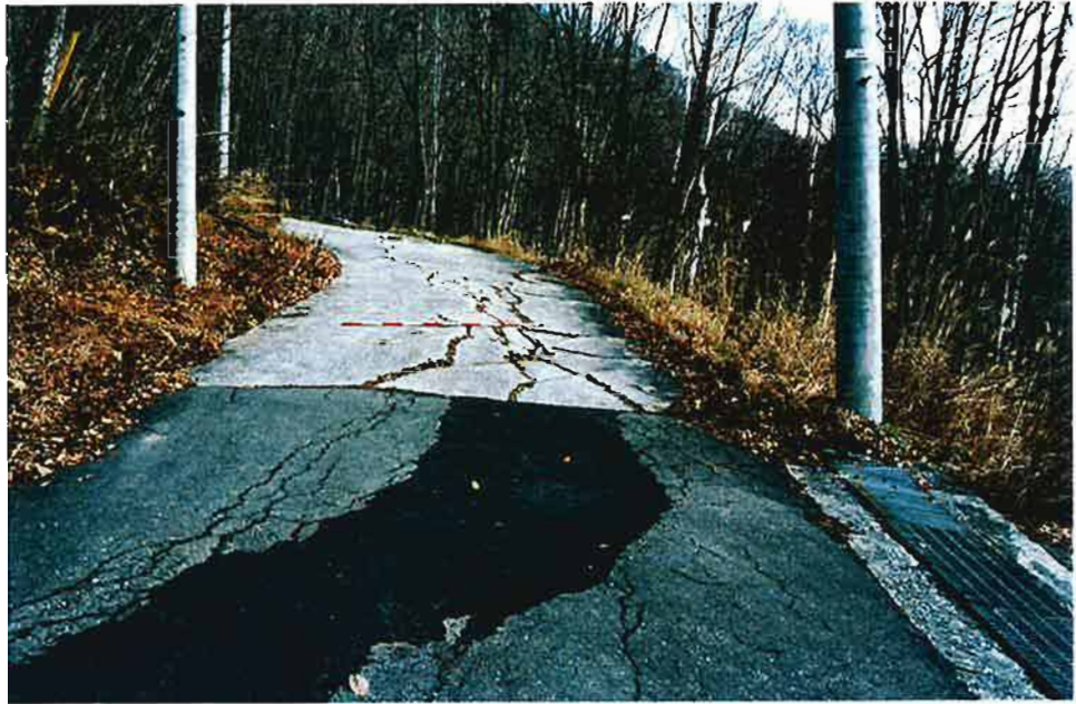
H9.12 始撮影 Aブロック頭部。村道の変状。
