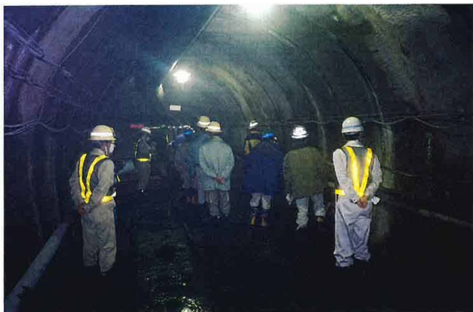
排水トンネル工施工中に切羽崩落の著しかった測点No.253.7付近 写真-4 について側壁漏水調査とトンネル変状調査を行った。
