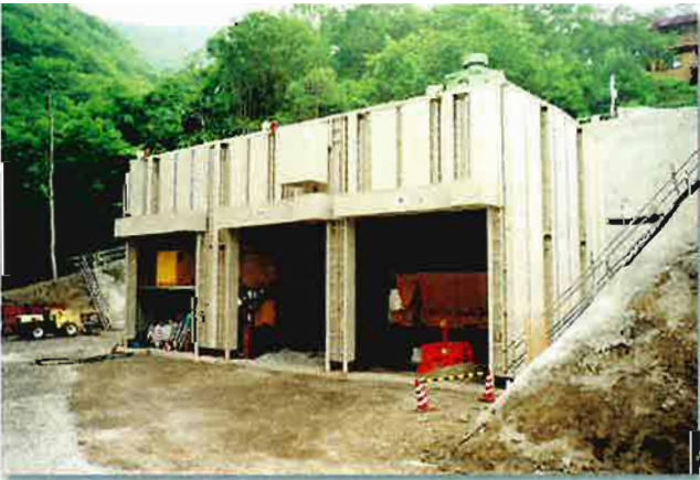
吹付プラント
