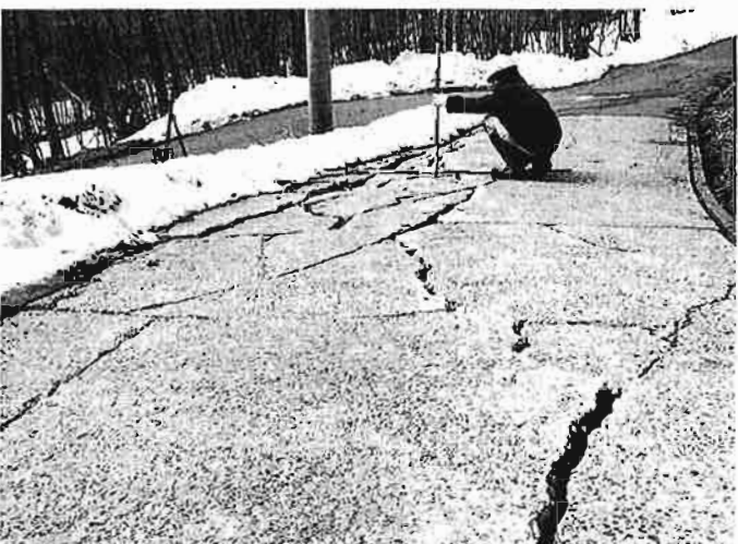
⑥ Aブロック頭部の村道に現れた亀裂
