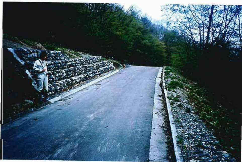
H12.5.11 撮影 Aブロック東頭部。村道の変状。 H11.4 補修。変状は認められない。
